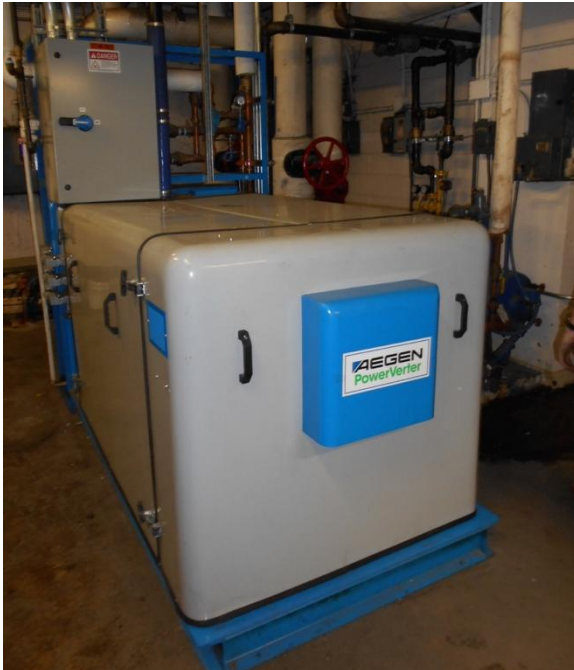
75 kW Cogen Unit
