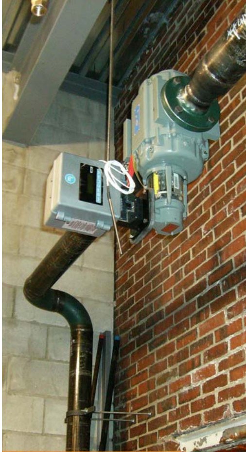
Gas Meter (FG)
